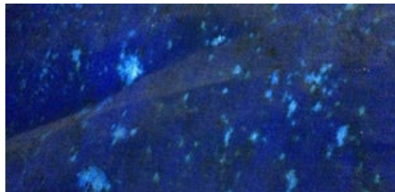
Abb. 11: Wand mit Schimmelbefall unter UV-Licht
