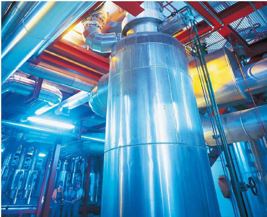
Anlagen der Stadtwerke Bielefeld zur Fernwärmeversorgung. Bild: Stadtwerke Bielefeld
